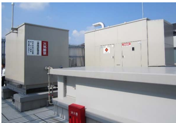
図 6-20 自家発電設備の例
