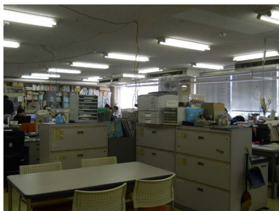
図 2-13 天井からの配線（別館）
