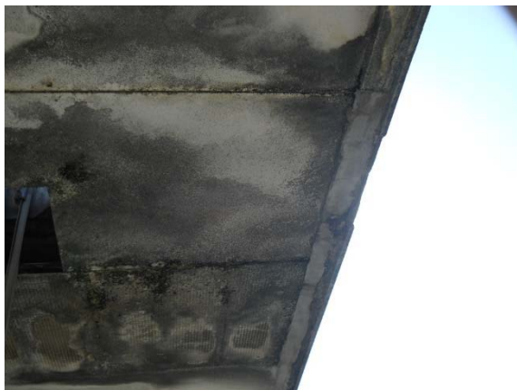
図 2-4 庇先端のモルタル剥離（上下水道局）
