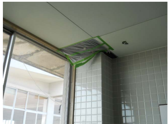
図 2-5 雨漏り（上下水道局）
