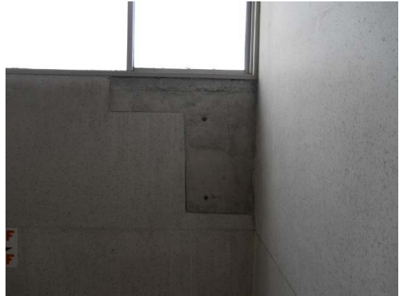
図 2-3 内壁のモルタル剥離（別館）
