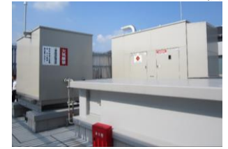
図7 自家発電設備の例
