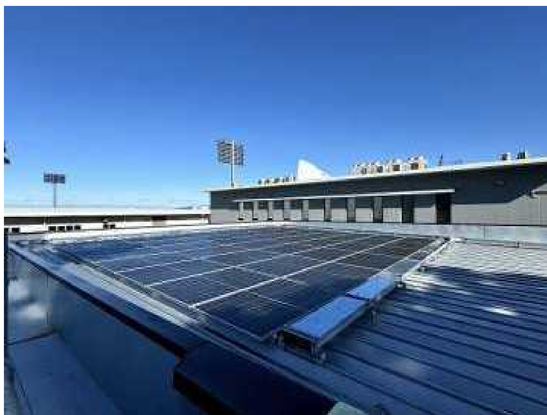
ポートルース大村における太陽光パネル設置
