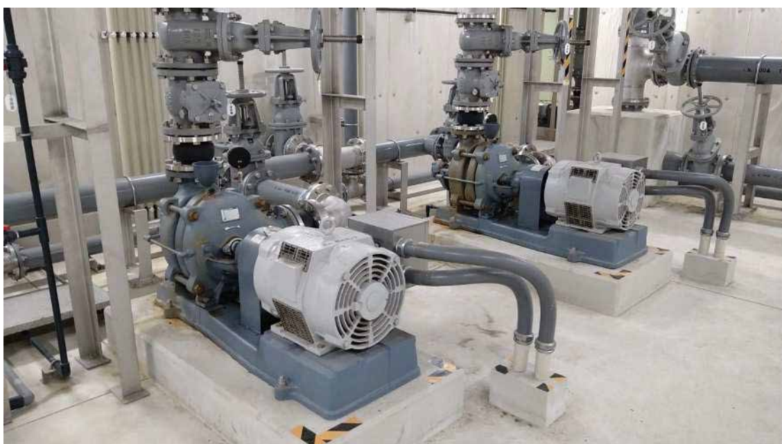
省電力送水ポンプ
