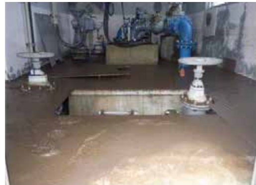
今富水源浸水後状況
