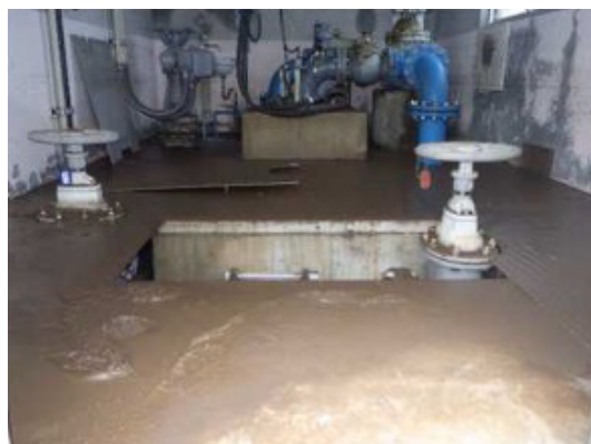
今富水源浸水状況(R2)
