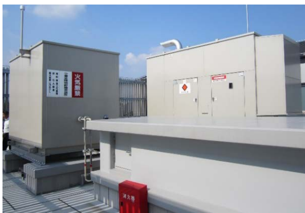
図 6-20 自家発電設備の例
