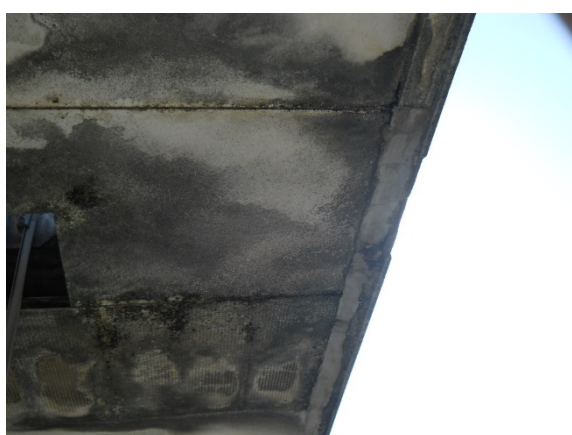
図 2-4 庇先端のモルタル剥離（上下水道局）
