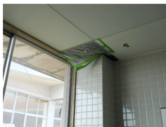
図 2-5 雨漏り（上下水道局）
