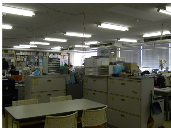
図 2-13 天井からの配線（別館）
