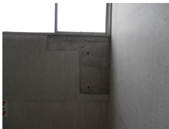
図 2-3 内壁のモルタル剥離（別館）
