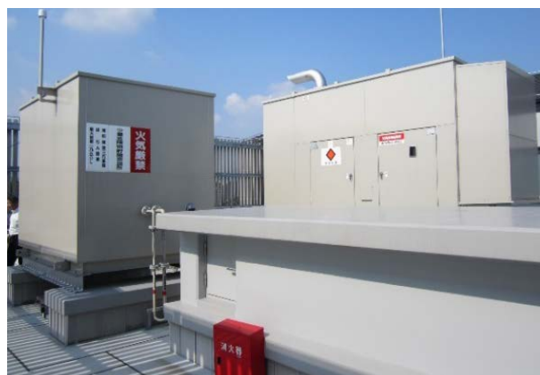
図 19 自家発電設備の例
