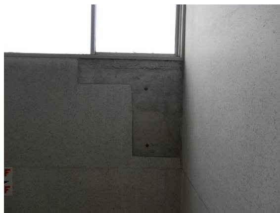
内壁のモルタル剥離（別館）
