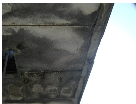
底先端のモルタル剥離（上下水道局）
