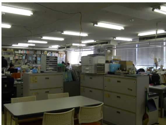
天井からの配線（別館）
