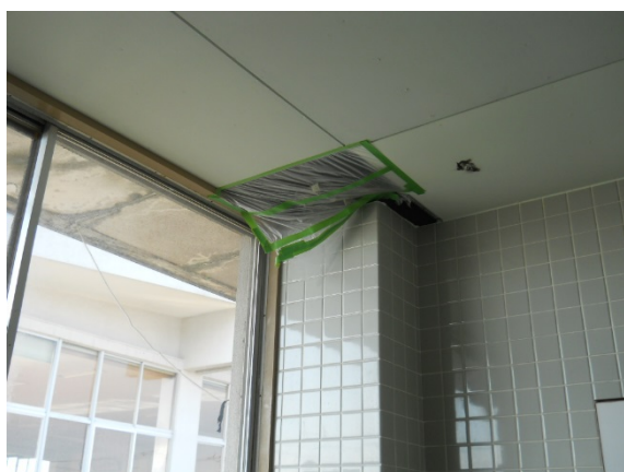
雨漏り（上下水道局）
