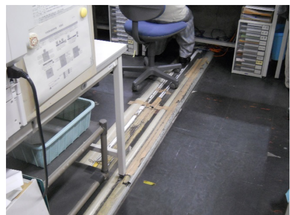
床への配線（本館）
