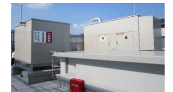
図7 自家発電設備の例
