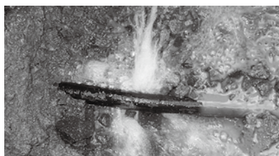
水道管の老朽化による漏水状況
