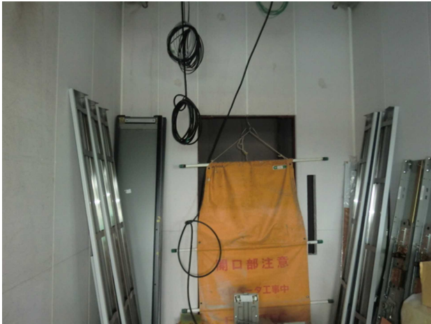
EV 開口部落下防止シート
