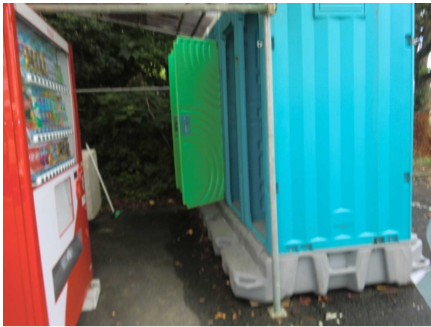
作業員用トイレ (男女共用)
