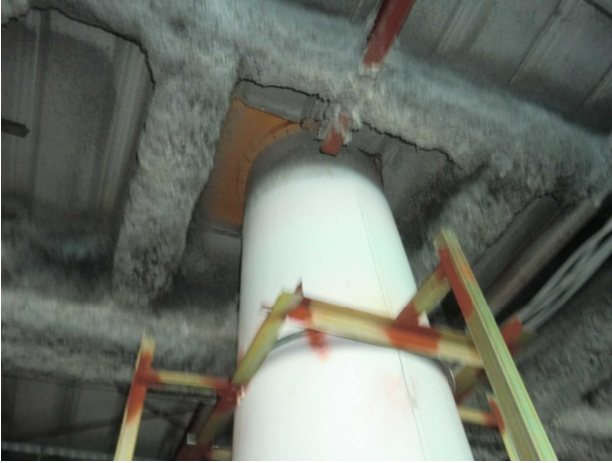
既存柱と屋根折版取合い部（手直し前）
